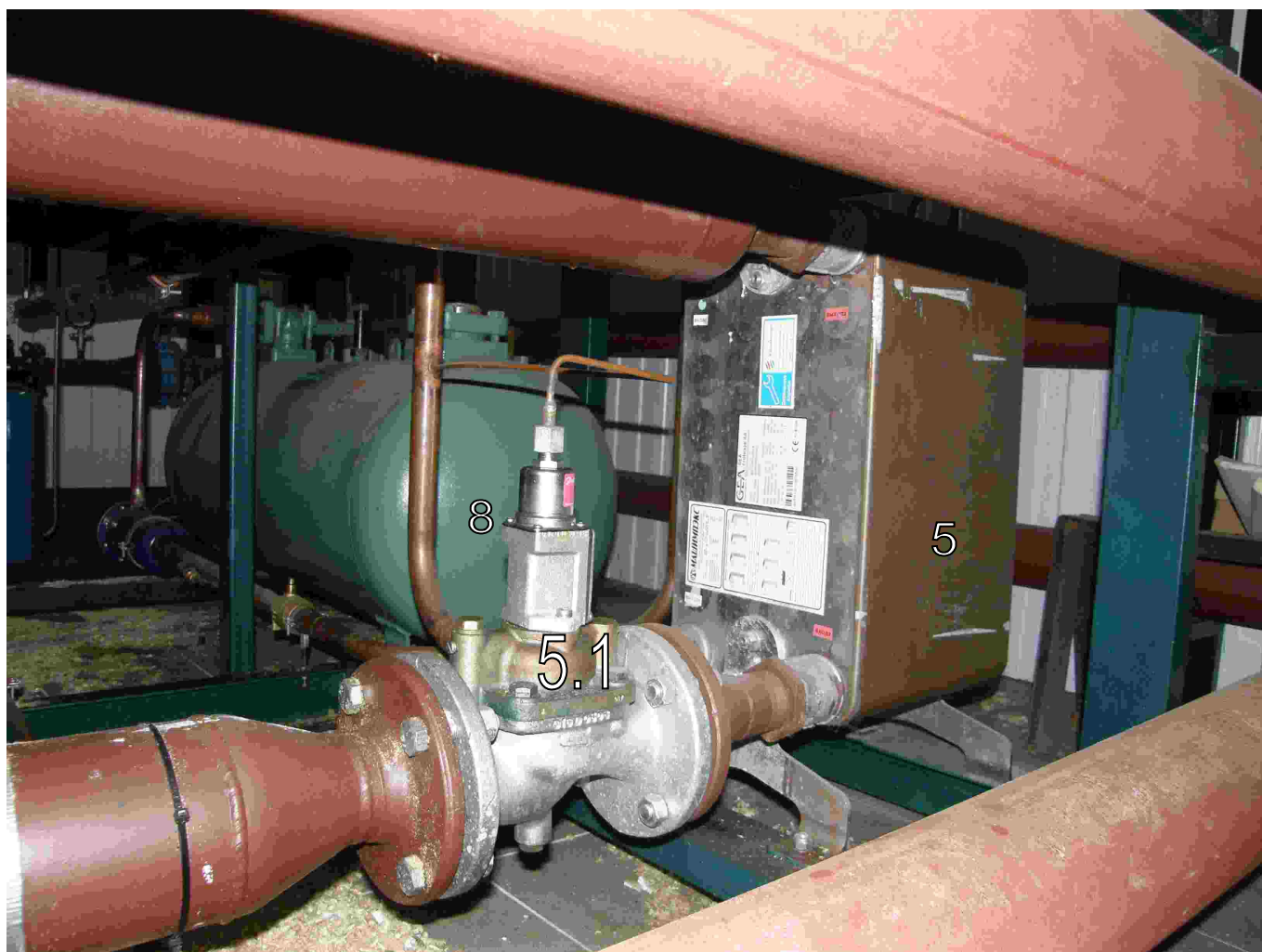
рис.7 (конденсатор-теплообменник, ресивер ВД)
